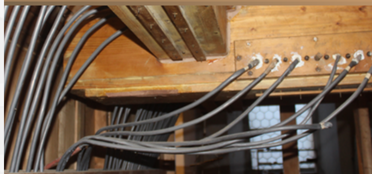
poškození traktury a pneumatických rozvodů
